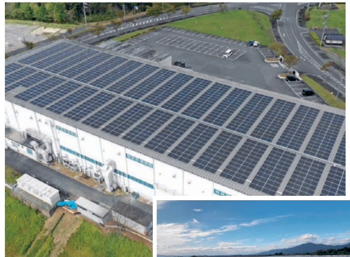
▼屋上に設置した太陽光パネル
