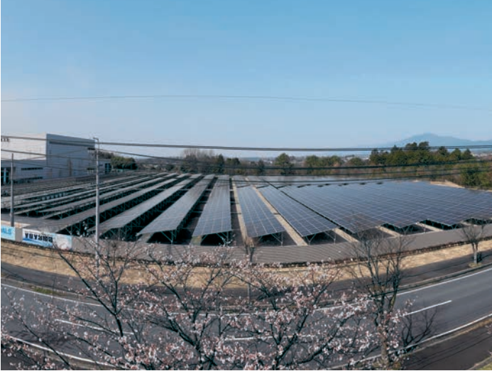
▼敷地内に設置した太陽光パネル
