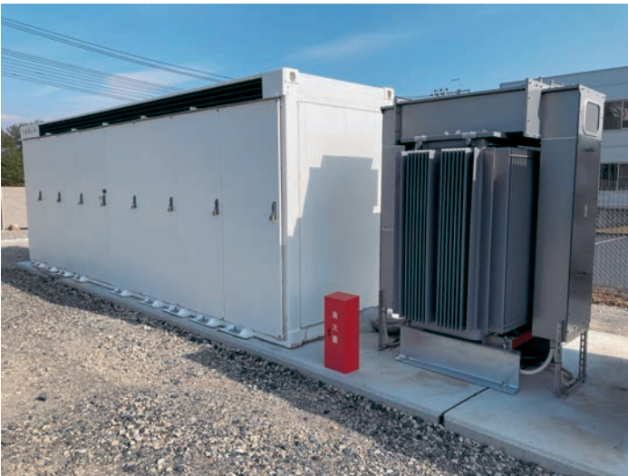
▼蓄電池システム
